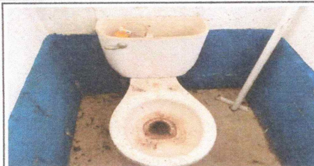
Foto 1: Los baños escolares no estan funcionando debido a que se averiaron, la red de drenaje esta colapsada como tambien la red del agua entuvada.
