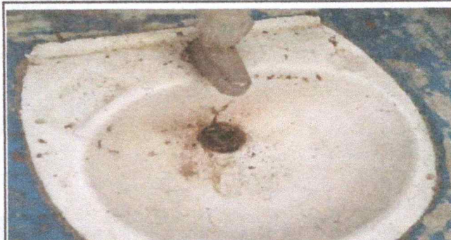
Foto 2: los lavamanos estan en muy mal estado, ya que estan deteriorados asi como su red de agua y drenaje.
