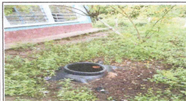
Foto 3: La fosa se encuentra colapsada y ya no puede cumplir con su funcion de manera adecuada.
